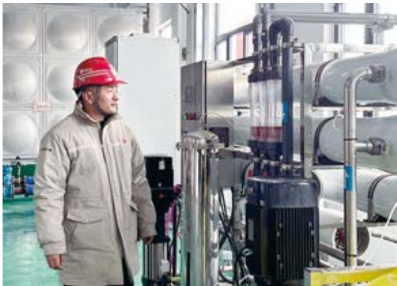
大唐兴海清洁能源供暖项目职工巡检电气设备和热力设施（班玛冷直/摄）
